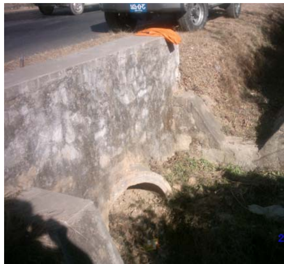
ढुंगामाटोले पुरिने लागेको कलभर्ट
