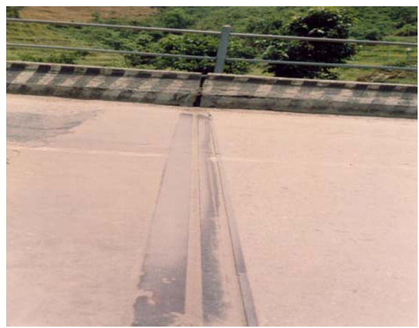
पुलको जोर्नीको खाली भाग (एक्सपान्सन ज्वाइन्ट) माटोले भरिएको (यो ज्वाइन्ट सधैं सफा राख्नुपर्छ )
