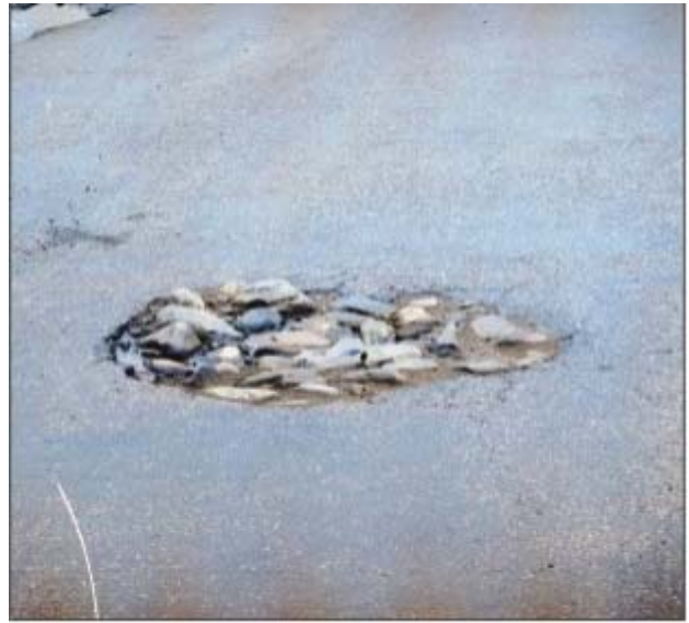
सडक सतहको ठूलो खाल्डोमा ढुंगा माटोले पुरेको
