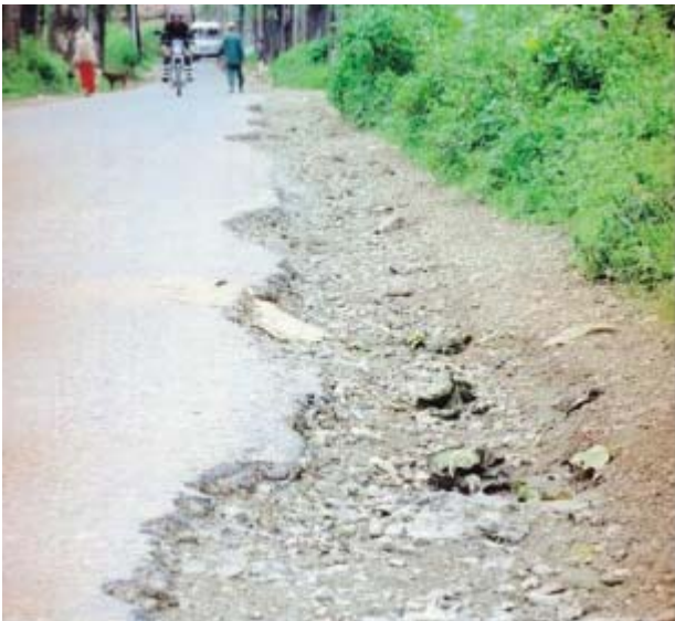
पानीले बिगारी खाल्डो भएको सडक किनारा
